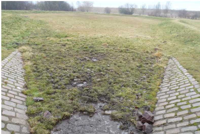
Versickerungsbecken kanalgespeist mit vorgeschaltetem Schachtsandfang
