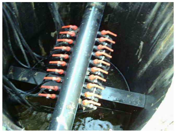
PKA Buchholzmühle – kombinierter Zu- und Ablaufschacht (LAU 03/2005)
