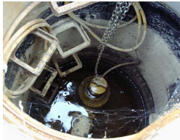
Abb. 2.2-6: PKA Leimbach 2 - Ablaufschacht Pflanzenbeete mit Pumpe (LAU 07/2008)
