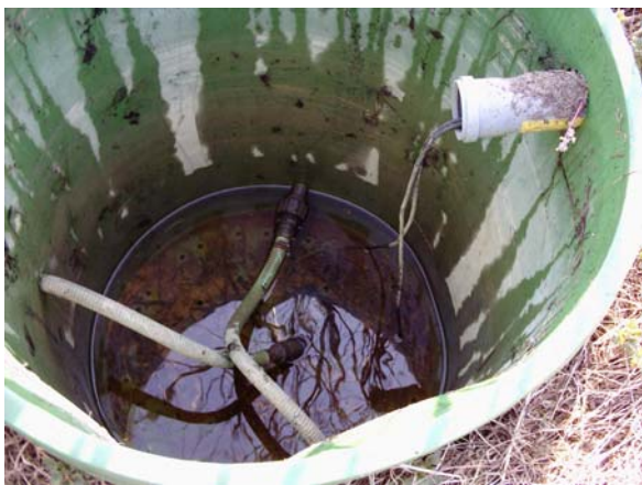
Abb. 4.2-14: PKA Dietrichsdorfer Mühle – Sammel-schacht mit Beschickungs- und Ablaufpumpe (LAU 03/2005)
