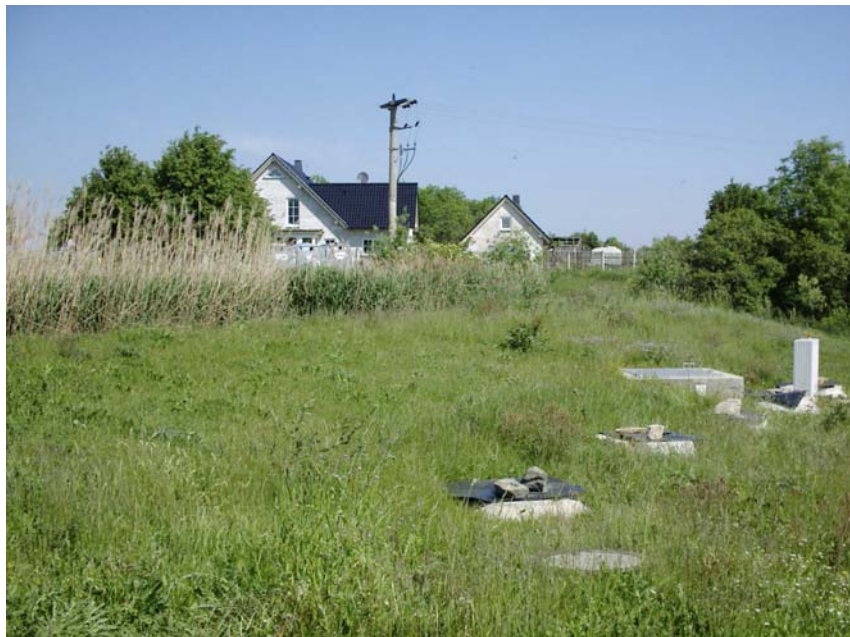
PKA Golzen/Krawinkel – Vorklärung, Zulauf- und Ablaufschacht zu bzw. von den Pflanzenbeeten, Verteilerschacht sowie Pflanzenbeete im Hintergrund (LAU 05/2007)
