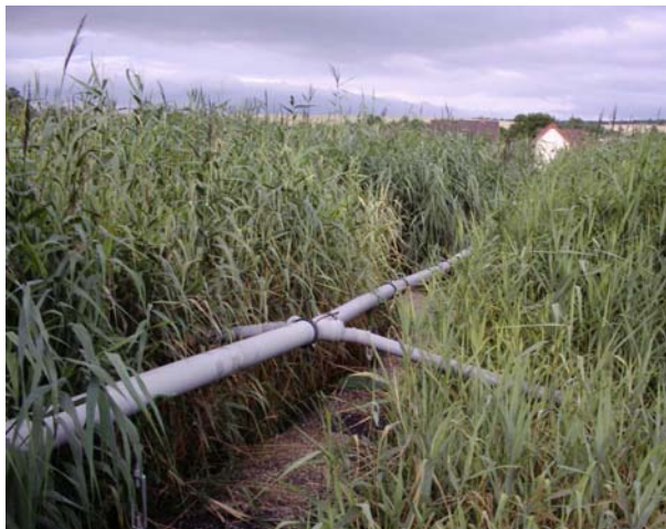
Abb. 2.2-5: PKA Leimbach 2 - Pflanzenbeete mit Beschickungsrohren (LAU 07/2008)
