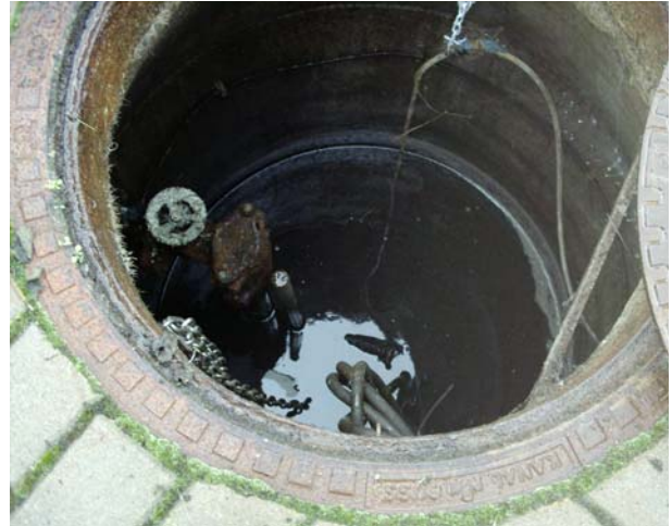
Abb. 2.1-4: PKA Iden - Ablaufschacht Vorklärung (LAU 08/2006)
