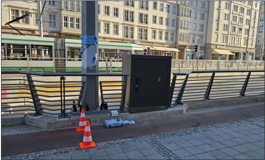
Abbildung 4: Sondermessstation Magdeburg/City-Tunnel, Foto LAU (08/09/2023)
