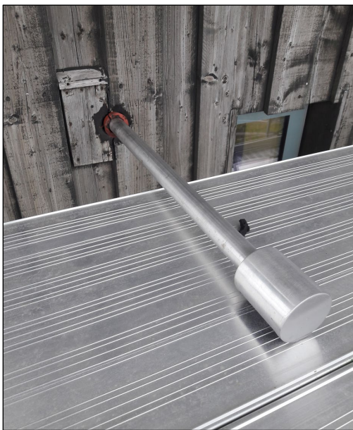
Abbildung 3: Probenahmesystem der Messstelle Brocken in Kontakt mit dem Baugerüst (vor der Demontage), Foto LAU (08/06/2023)
