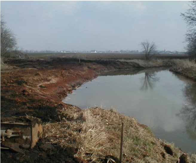
Abb. 13: Im Zuge eines Flurneuordnungsverfahrens als Kleinbiotop und Amphibienlaichgewässer neu angelegte Grabentasche bei Groß Naundorf (Foto: B. SIMON).
