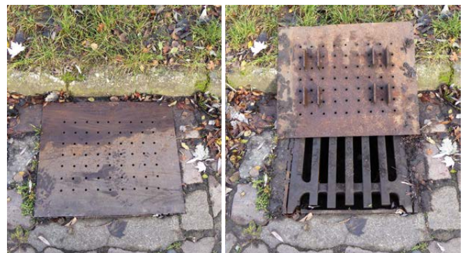
Abb. 7 a, b: Abnehmbare Gullyabdeckungen verhindern das Hineinfallen von wandernden Lurchen in das Abwassersystem (Foto: J. BUSCHENDORF).
