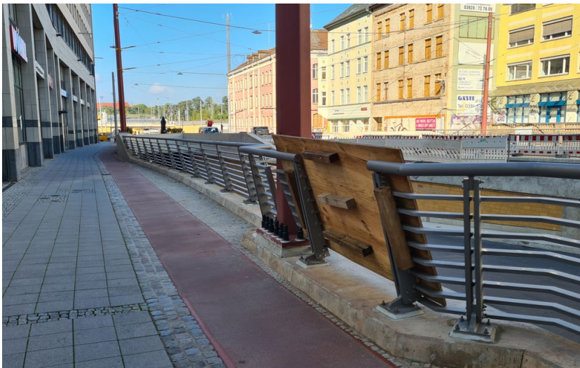
Abbildung 3: Detailaufnahme vom Standort der Sondermessstation, Holzplatte als provisorische Absturzsicherung, Foto LAU (29/09/2022)
