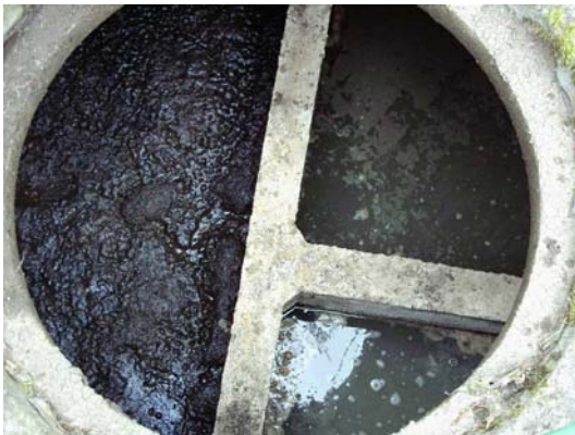
Abb. 3 : Dreikammerausfallgrube – als Vorklärung bei einer Kleinkläranlage
