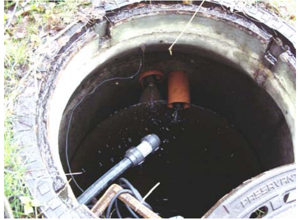
Abb. 11: Pumpe im Ablauf- und Kontrollschacht - Brauchwasserentnahme
