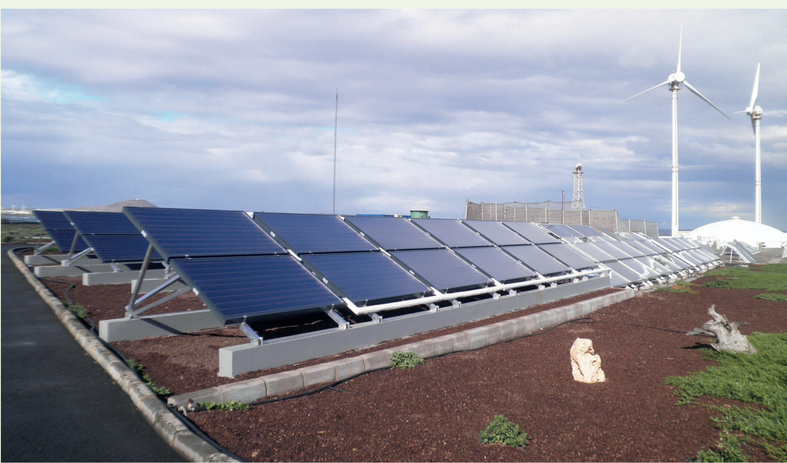
Bild: Solarbetriebene Wasserentsalzungsanlage auf Gran Canaria Quelle: Fraunhofer-Institut für Solare Energiesysteme
