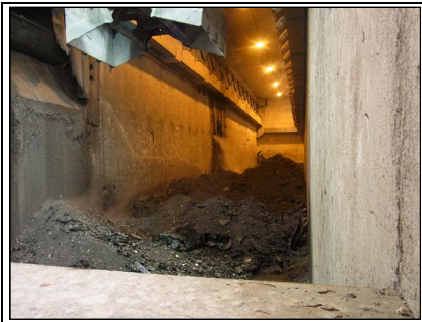
Abbildung 1: Schlacke im Schlackebunker
